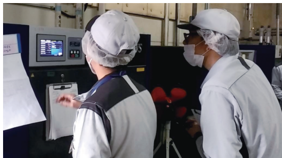
コンプレッサー設備稼働状態を確認
