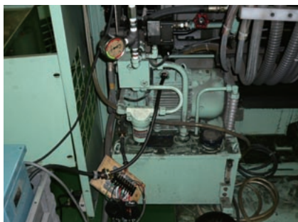
図9 既存ユニポンプにインバータ制御キットを追加
