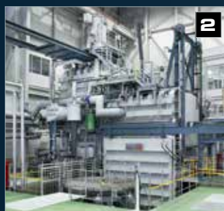
VIM炉(真空誘導溶解) 3ton
